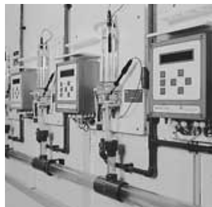
Im Schwimmbad Volketswil wird der Chlorgehalt für jedes Becken einzeln gemessen und geregelt.
