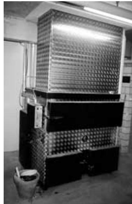
Der Stückholzkessel mit der charakteristischen Füllschachtverlängerung.
