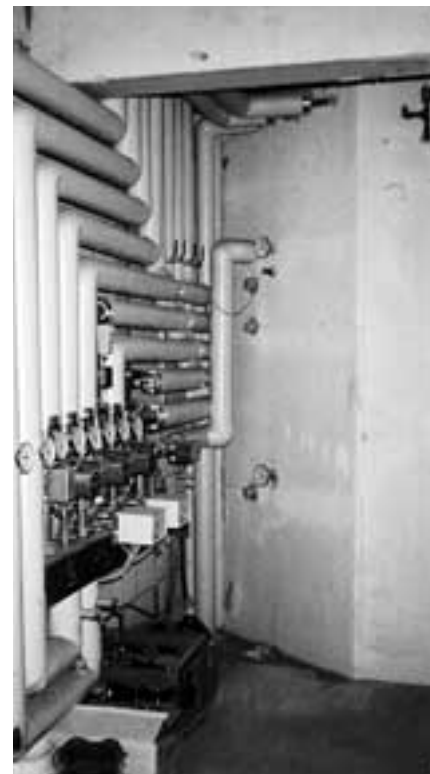
6,5 m 3 -Speicher (rechts) mit Heizverteilung.
