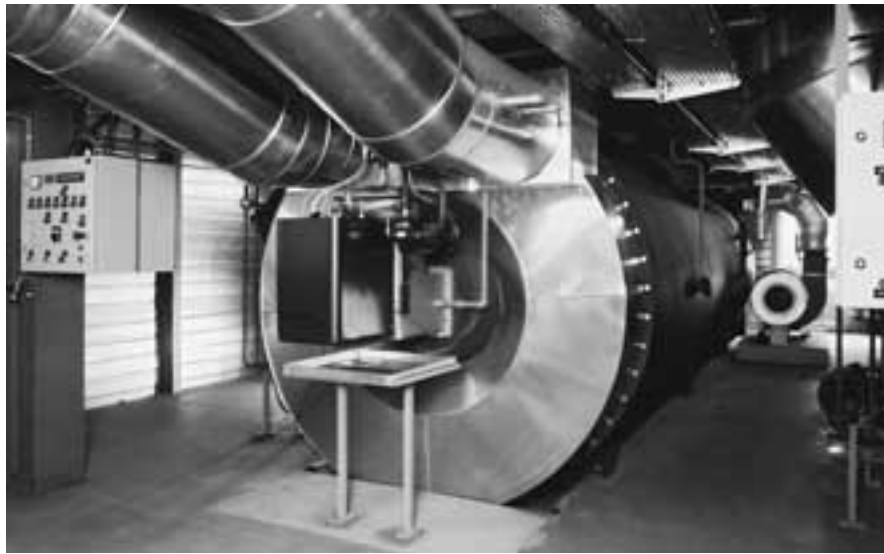
In der Brennkammer des Rekuperators werden die organischen Rückstände aus dem Schmelzprozess bei 900 °C verbrannt. Gleichzeitig wird die Abwärme genutzt, um den Ofen vorzuheizen. (Foto: Flumroc AG)
