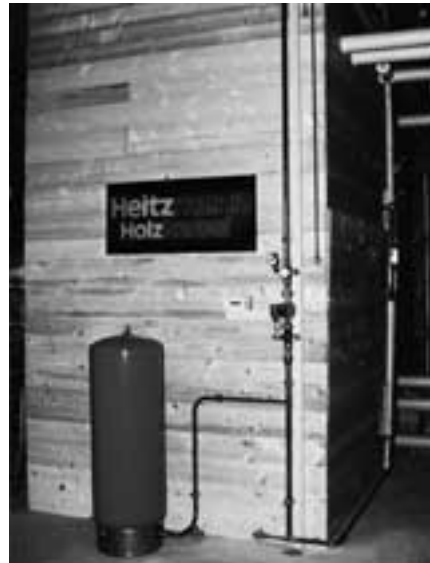
Der 10000-Liter-Heizmann-Wärmespeicher mit integriertem Warmwasserspeicher und Solarwärmetauscher.
