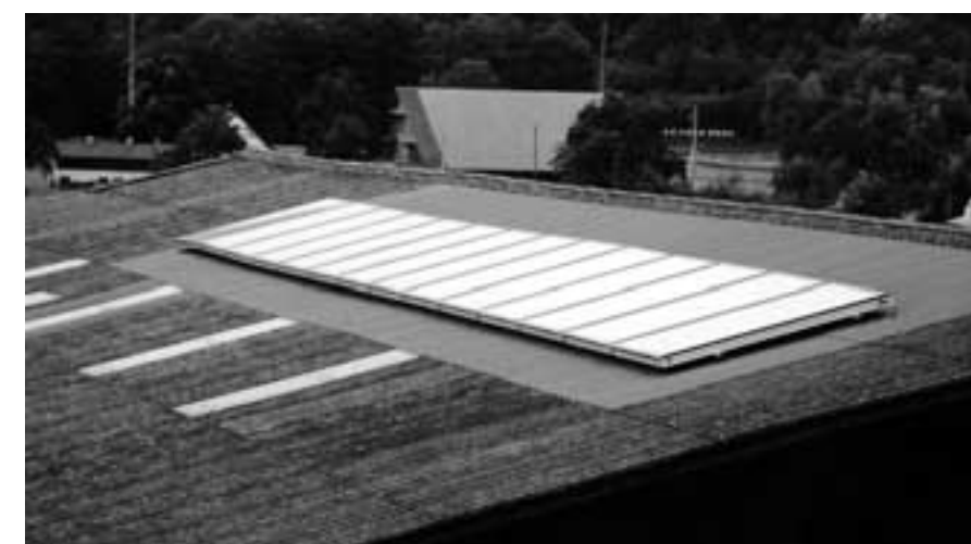
Blick auf das Dach des Biohofs Widacher in Malters mit dem optimal integrierten Sonnenkollektorfeld (32 m²). (Fotos: Heitzmann AG)
