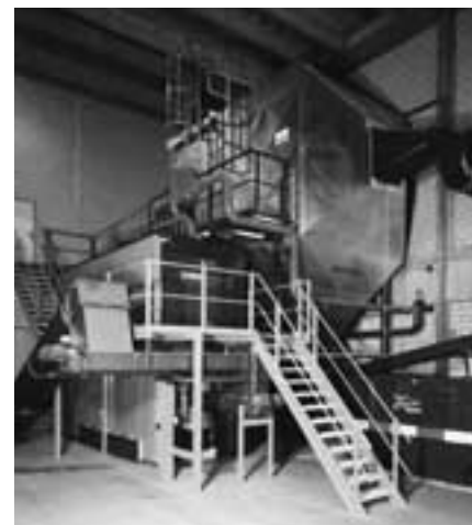
Altholz-Verbrennungsanlage der Schnider AG, Transporte/Recycling, in Engelburg SG (Feuerungsanlage mit Elektrofilter). (Foto: Daniel Germann/Schmid AG)
