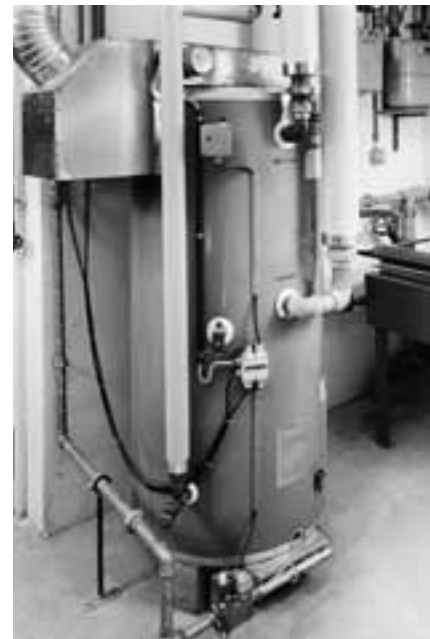
Auch bei grossen Gasboilern bis 350 kW muss nur CO gemessen werden.
