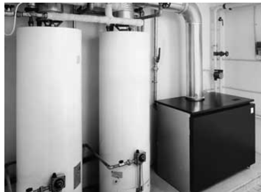
Den Heizkessel rechts aussen muss man nicht messen, er ist in der SVGW-Liste zu finden. Bei den Gasboilern links ist nur CO zu messen. (Fotos: VSG)
