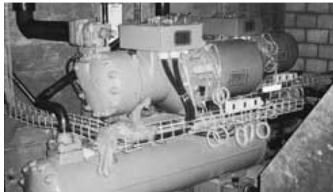
Luft-Wasser-Wärmepumpe, Elektroanschluss 75 kW, Heizleistung 470 kW.
