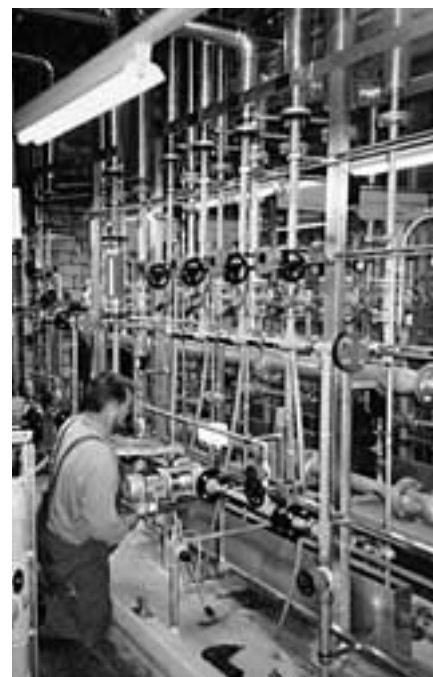
Der Übergang von der alten auf die neue Verteilzentrale konnte dank des «Instaflex»-Systems in kurzer Zeit vollzogen werden.
