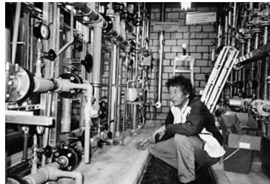
Peter Friedli von der Installationsfirma Ramseyer und Dilger AG hat den 5-tägigen Instruktorienkurs bei «Georg Fischer» absolviert.
