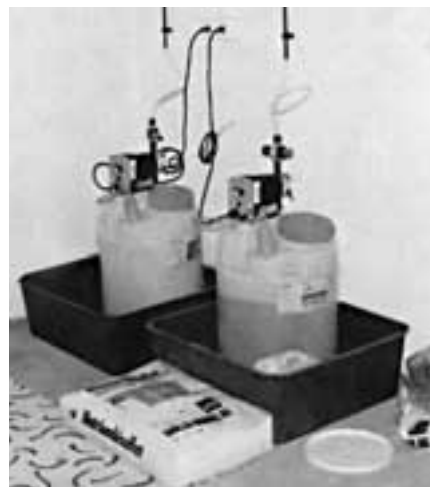
Eine Wasseraufbereitungsanlage enthält in der Regel zwei Vorratsbehälter. Im linken Behälter wird Chlorgranulat gelagert, über den rechten Behälter erfolgt die pH-Regulierung. In den linken Behälter, der noch geringe Mengen des früheren Produktes zur Chlorherstellung enthielt, wurde das neue Produkt eingefüllt. Die chemische Reaktion begann. (Foto: Chemiestützpunkt Jona, M. Wyss)
