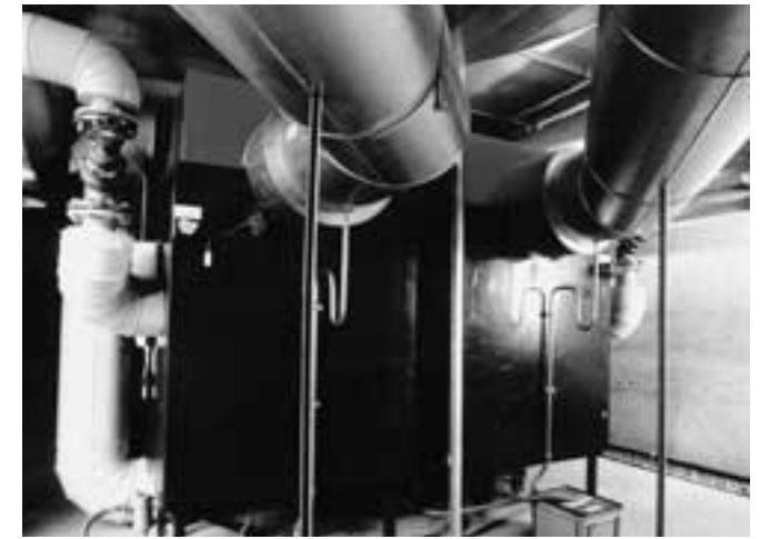
Die Kondensationsrekuperatoren hinter den Heizkesseln sorgen für optimale Energieausnutzung.
