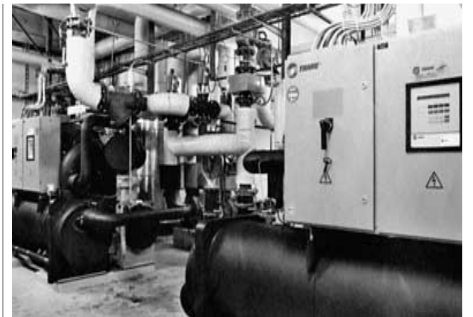
Das Freizeitzentrum «Sântispark» in Abtwil SG hat von Chlorgas auf Elektrolyse-Kochsalz umgestellt. Im Bild die neuen Wärmepumpen.
