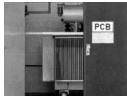
Transformator mit PCB-haltiger Kühlflüssigkeit.
