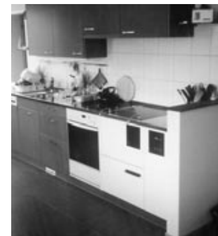
Der im offenen Erdgeschoss installierte Holz-Zentralheizungsherd deckt den grössten Teil des Energiebedarfs der Familie Ruckli in ihrem Hausteil. (Fotos: Holzenergie Schweiz)
