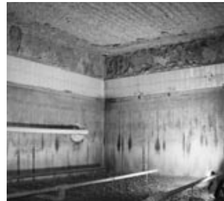
Ausgleichsbecken zum Aufbereiten des schwefelhaltigen Wassers, extreme Betonschäden in der Gaszone.
