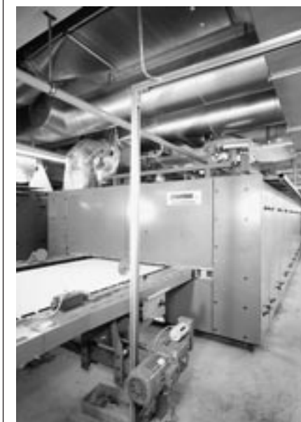
Der Trockner wurde von Flüssig- auf Erdgas umgestellt.
