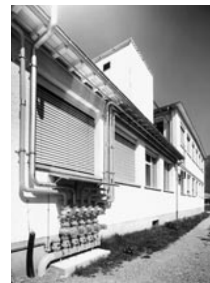
Die Gasverteilung zu den einzelnen Verbrauchern benötigt weniger Platz als der frühere Flüssiggastank.
