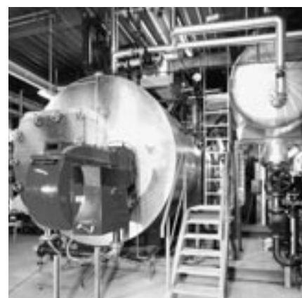
Der neue Dampfkessel bei Schoeller Textil mit modulierendem 6,5-MW-Gas-Gebläsebrenner; rechts oben der kondensierende Economiser.
