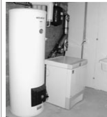
Es stand nur ein minimaler Platzbedarf für die Wärmeerzeugung und die Wassererwärmung zur Verfügung.
