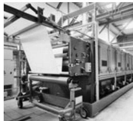
Einer der Spannrahmen, die heute ebenfalls mit Erdgas funktionieren; im Vordergrund rechts die Gaszuleitung zu den Brennern.
