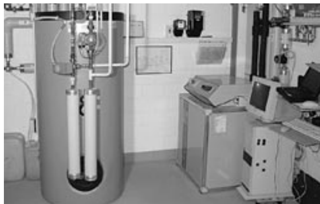
Elektrowärmepumpe mit nachträglich eingebautem Energiemanager RVP550 (rechts im Bild). Mehr als 500 Grundschemas sind im Gerät bereits hinterlegt.
