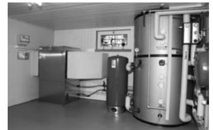
Wärmepumpen (links), kombiniert mit solarer Brauchwassererwärmung (rechts), eine beliebte und bewährte Kombination. Luft/Wasser-Wärmepumpe und 1500-Liter-Speicher in einem Einfamilienhaus, das bis zur Sanierung pro Jahr 4200 Liter Heizöl verbrauchte. Fotos: Fördergemeinschaft Wärmepumpen Schweiz FWS
