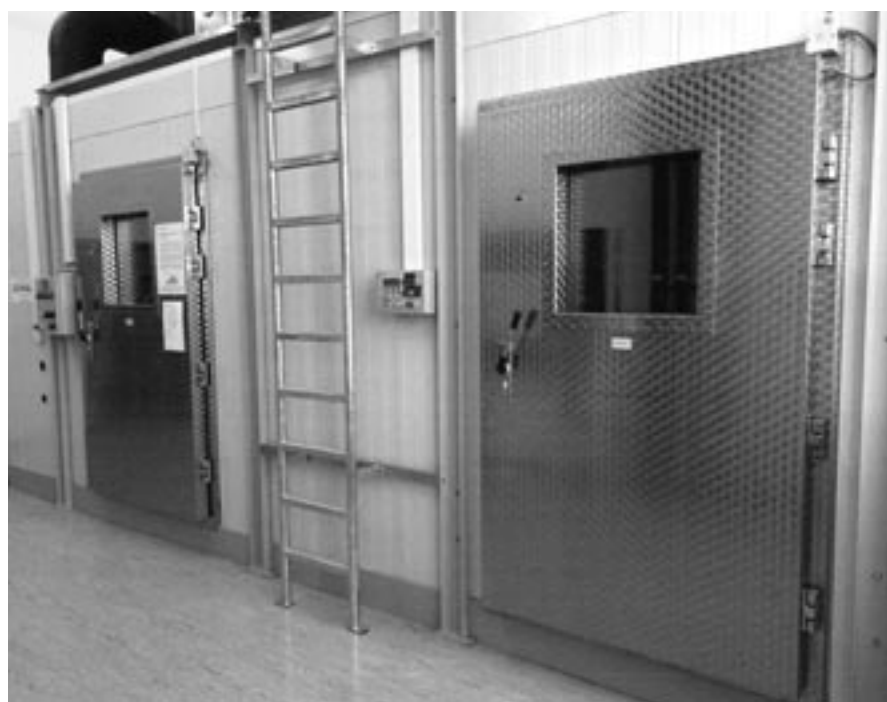
Zwei Klimakammern stehen in Buchs zur Verfügung.
