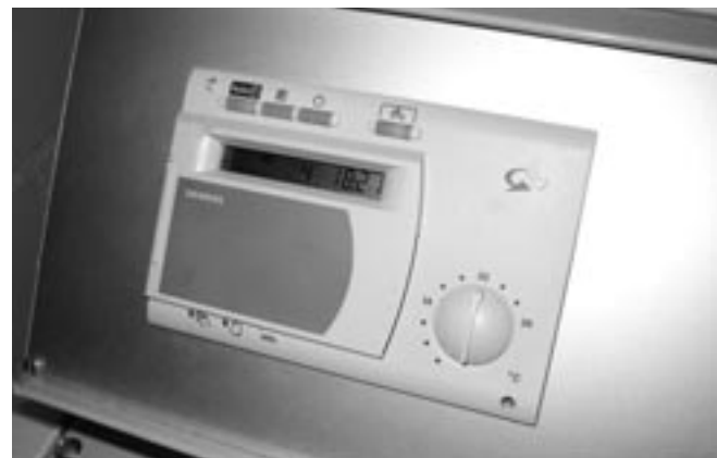
Bedienebene des Energiemanagers RVP550 direkt an der Wärmepumpe. Fotos/Schemas: Siemens Building Technologies/Peter Bulgheroni
