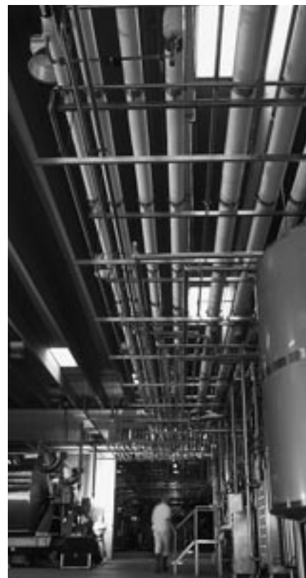
Rohrleitungssysteme für den Transport von Kühlwasser in verschiedensten Industriezweigen.
