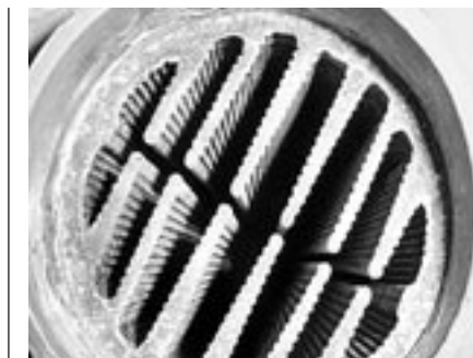
Schnitt durch das Verbundrohr nach acht Jahren Betriebsdauer.
