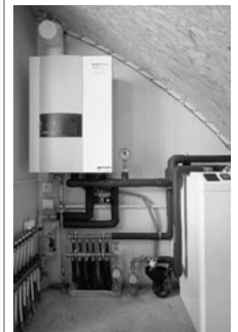
Gas-Kondensationskessel und Beistellboiler der Maisonette-Wohnungen – untergebracht im Technikraum im Dachstock.
