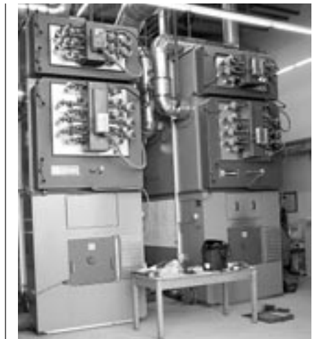
Blick auf die Kesselanlage einer modernen Holzfeuerung.
