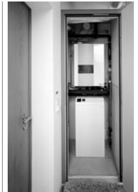
Gas-Kondensationskessel 0,9–9 kW und Beistellboiler der Stockwerkwohnungen in einem Kasten neben dem Lift.
