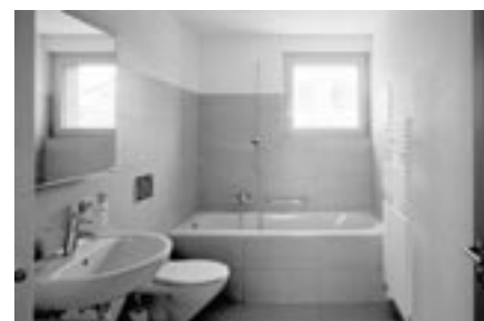
Zuluftkanal oben links: Der Architekt hat nicht gerne einbetonierte Rohre.
