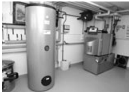
Die Ölheizung (rechts) und eine Solaranlage (Foto mit Solarspeicher, links) lassen sich optimal kombinieren.
