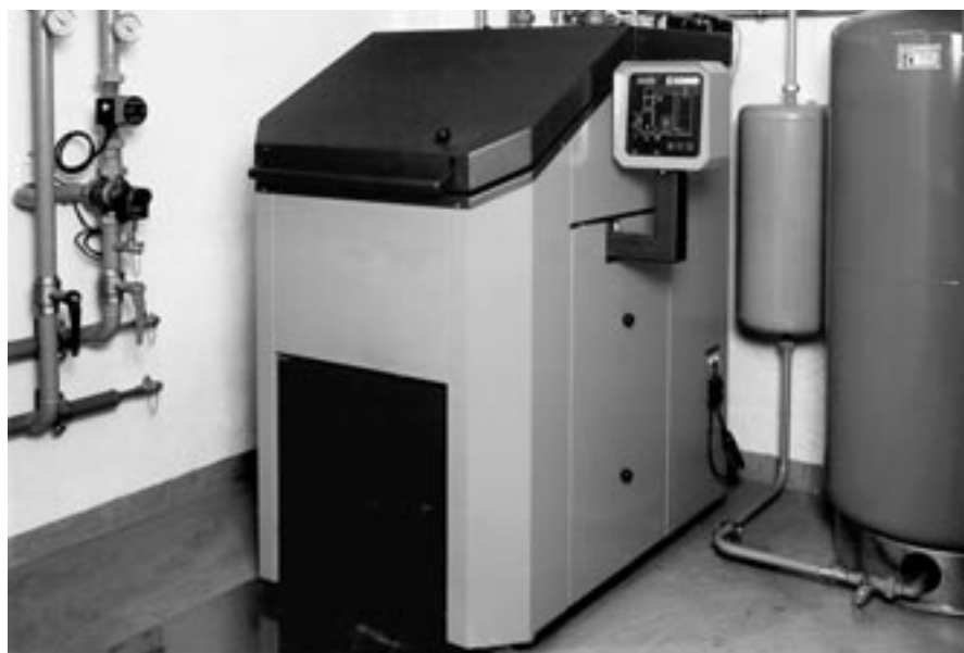
Auch Stückholz-Feuerungen tragen zur Nutzung des einheimischen Energieträgers Holz bei. Foto: Schmid AG, Eschlikon TG
