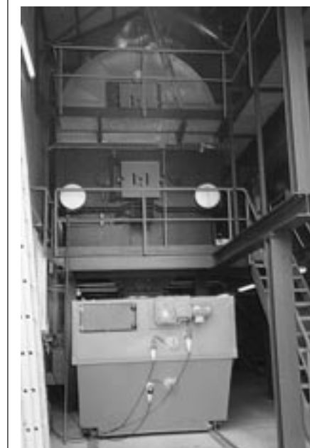
Der neue Holzessel in der Sägerei «Les Eplatures» in La Chaux-de-Fonds weist eine Leistung von 4 MW auf.
