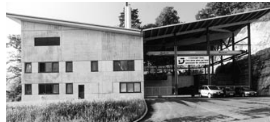
Eine weitere interessante Holzenergie-Anlage in der Westschweiz: Die in einen ehemaligen Steinbruch eingebettete Heizzentrale der Thormoréseau-Porrentruy SA in Pruntrut. Links das Betriebsgebäude mit dem Heizkessel, rechts das Holzschneitzsilos.
