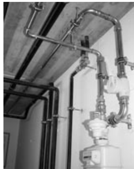
Trinkwasser-Installation mit «Geberit Mepla» und Gas-Installation mit «Mapress»-Edelstahl GAS 1.4401.
