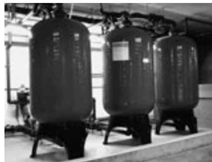
Die Micarna SA in Bazenhaid vertraut für die Wasseraufbereitung auf die Anlagen der Roshard AG, Küsnacht ZH.
