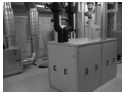
Auch grosse Wärmepumpen-Anlagen waren im letzten Jahr erfolgreich. Bild: Eine Wasser-Wasser-Wärmepumpe beheizt das neue Minergie-Gebäude der Firma Rotor Lips AG in Uetendorf Foto: Informationsstelle Wärmepumpen, Bern
