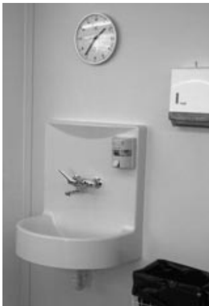
Bei der Zollikofner Stiftung für berufliche Integration GEWA wurden «Romay»-Waschtische aus Kunststoff, welche sich über eine hohe Kratzfestigkeit und lange Lebensdauer auszeichnen, in Rekordzeit installiert. Fotos: Romay AG
