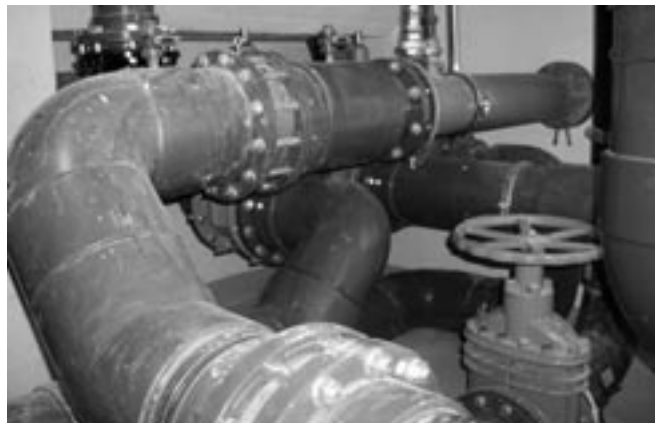
Die neuen Rohre im Technikraum.
