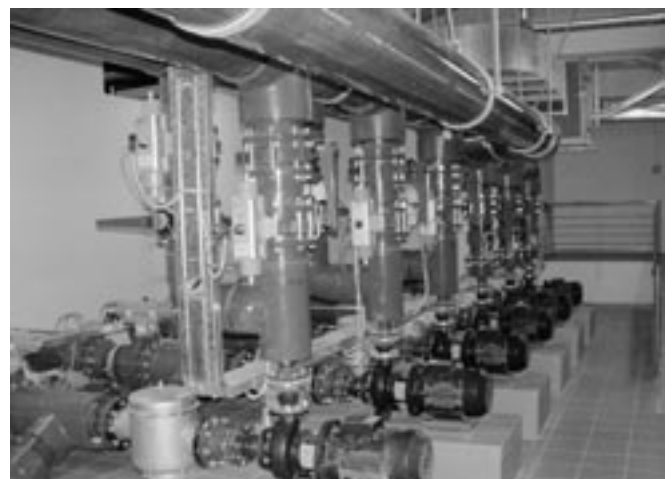
Rohrleitungssysteme, Automation sowie Mess- und Regeltechnik von GF Piping Systems sorgen für einen reibungslosen Betrieb des neuen Schwimmbades.
