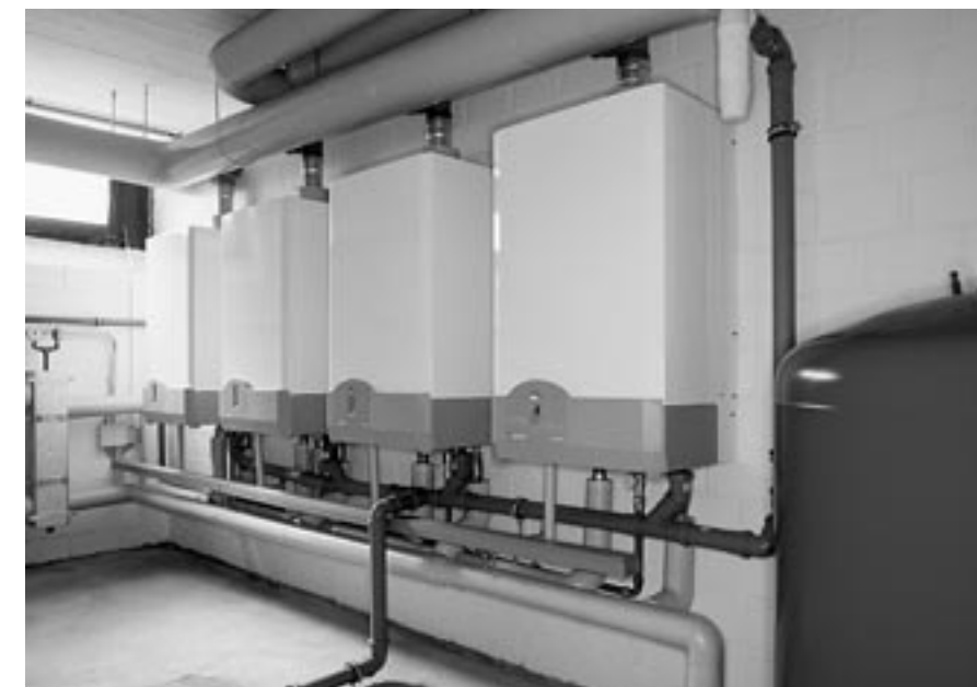
Kaskaden-Lösung mit Gas-Brennwert-Wandkesseln.
