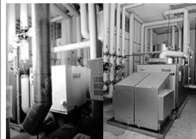
Fernwärmeversorgung ARA Zermatt.
