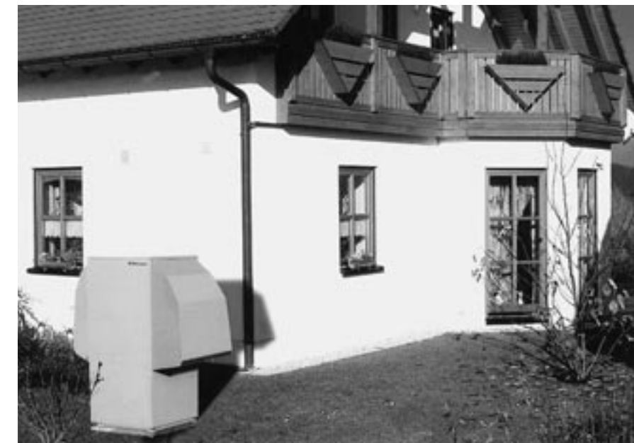
Wärmepumpe, ausserhalb des Hauses im Freien aufgestellt.
