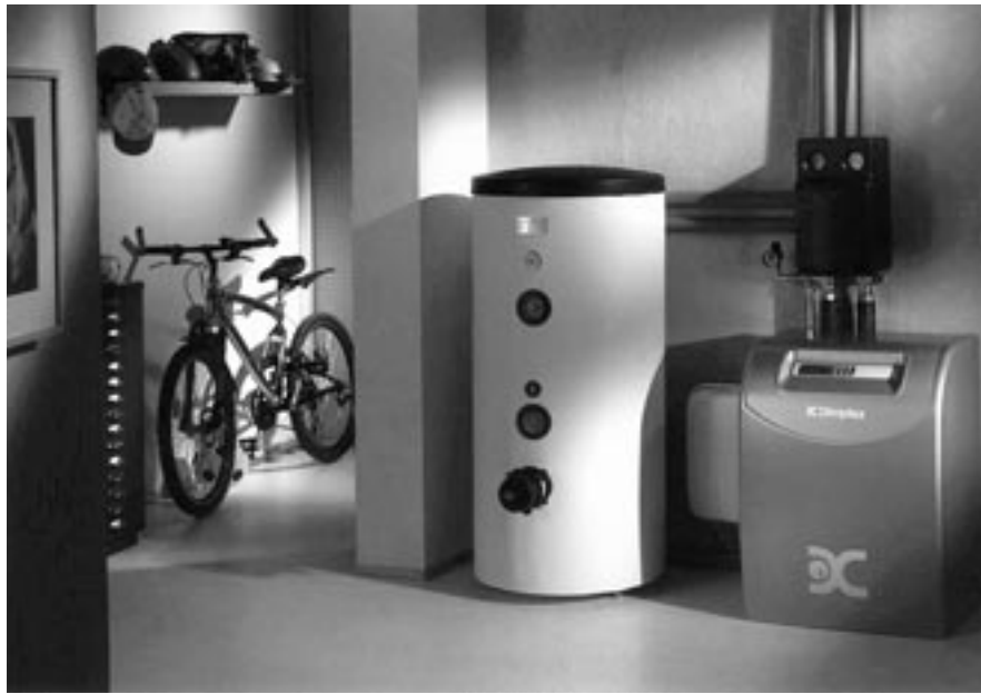
Wärmepumpe (rechts) mit Warmwasserboiler (links).
