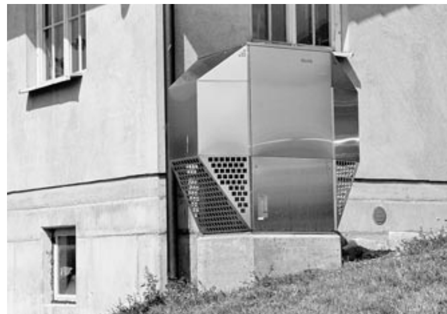
Blick auf die Elcotherm-Luft/Wasser-Wärmepumpe.
