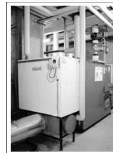
Abgaswärmetauscher Hotel Riffalp Resort, 2222 m ü. M.
