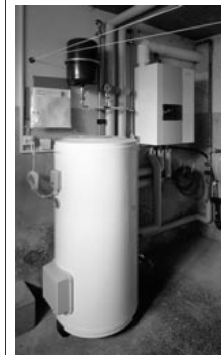
Gas-Kondensationskessel (2–15 kW), und 200-Liter-Boiler für jedes Haus.
