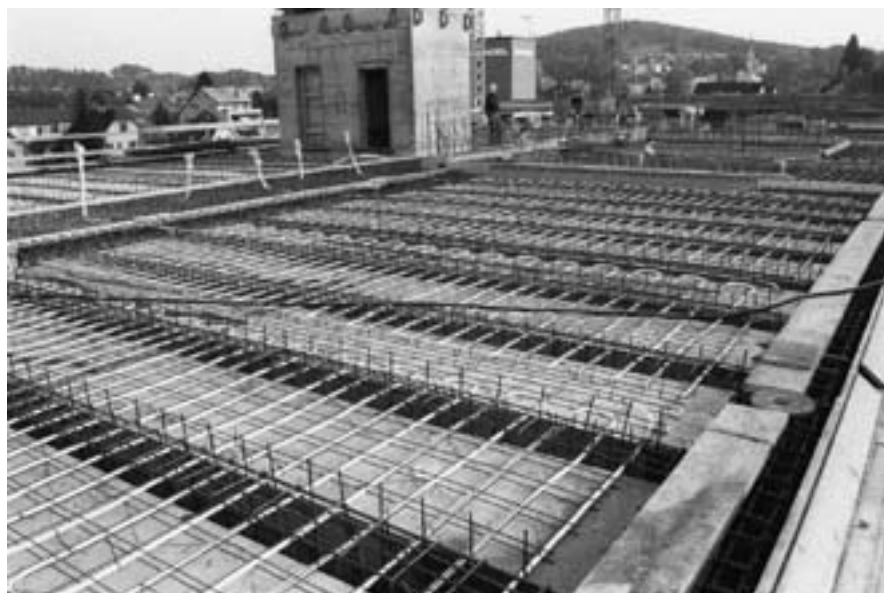
Vor dem Betonieren werden die Kunststoffrohre (weiss) des thermoaktiven Bauteils fest mit der Armierung verbunden. Foto: Empa
