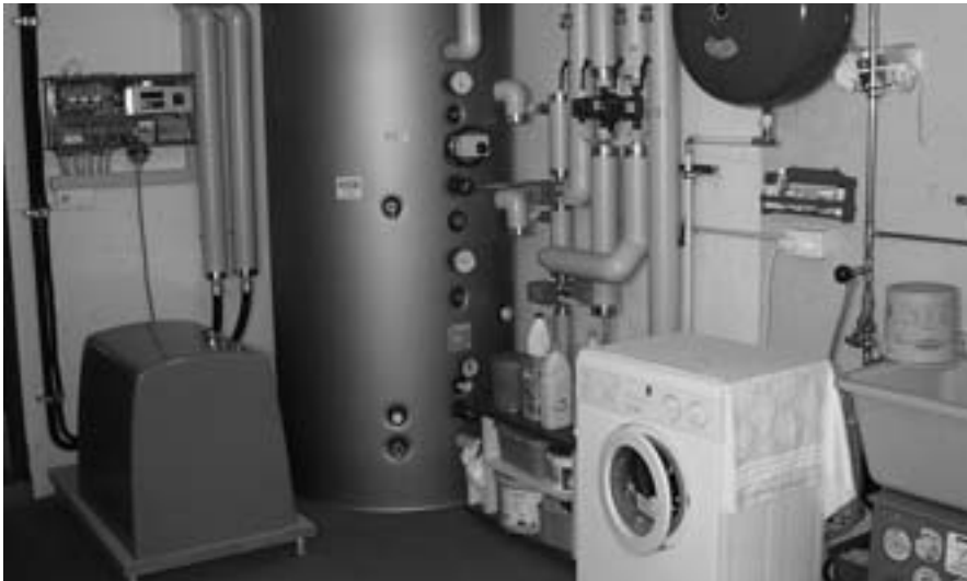
Eine Luft/Wasser-Split-Wärmepumpe für Heizung und Warmwasser mit einem 950 Liter fassenden Kombispeicher. Anstelle des Zentralspeichers findet nun auch die Waschmaschine Platz im Heizraum. Fotos: FWS
