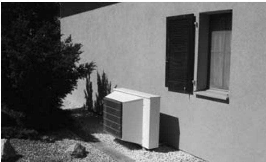
Der draussen aufgestellte Verdampfer (Konsole) einer Luft/Wasser Split-Wärmepumpe.
