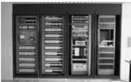
Die Zentrale der Rechner-Anlage mit dem Server im Untergeschoss.
