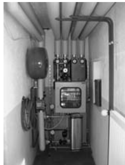
Wärme-Übergabestation eines an das «Thermoréseau»-Fernwärmenetz angeschlossenen Hauses u.a. mit Wärmetauscher, Wärmezähler und Steuerung.
