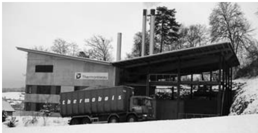
Die Holzschnitzel werden durch die Thermoboïs AG zur Heizzentrale «Thermoréseau» (Bild) in Pruntrut transportiert; im Winter 2005/06 waren dies total 36 000 m 3 .
