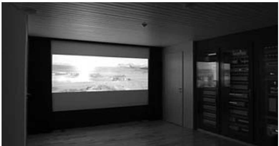
Home-Cinema-Raum mit Grossbildprojektion im Untergeschoss, rechts sichtbar die Rechner-/Steueranlage des gesamten TechHome.
