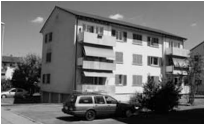
Vor der Modernisierung hatte dieses Gebäude in Staufen AG mit bekannten Problemen wie Schimmelpilz und Wärmebrücken zu kämpfen.
