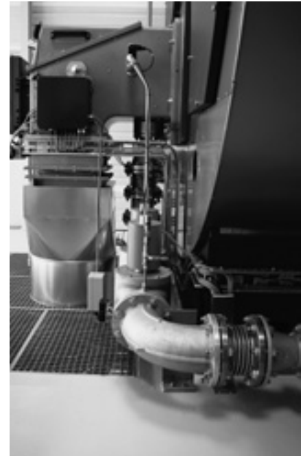
Der Kompensator vorne ist überflüssig. Dahinter: Befestigung der Gas-Strasse zwischen Flansch und Boden; hinten im Bild: der Kompensator unten am Brenner, flexibles Zwischen-Stück am Verbrennungsluft-Kanal.
