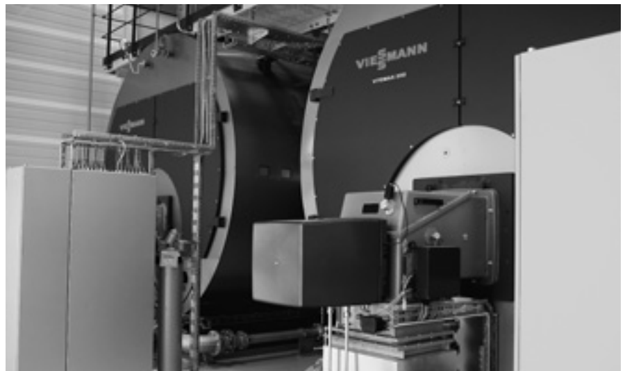
Die neue Dampf-Zentrale mit zwei 13-MW-Duobloc-Gas-/Öl-Zweistoff-Brennern.
