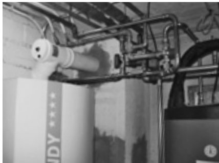
Öl-Brennwert-Heizkessel «Royal Condy» im Heizungs-Raum des EFH, mit Anschluss-Details für LAS-Abgas-System, Warm- und Kaltwasser-Leitungen sowie für das Heizungs-Wasser.
