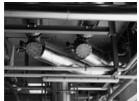
Befestigungen der Erdgas-Leitungen im Keller.
