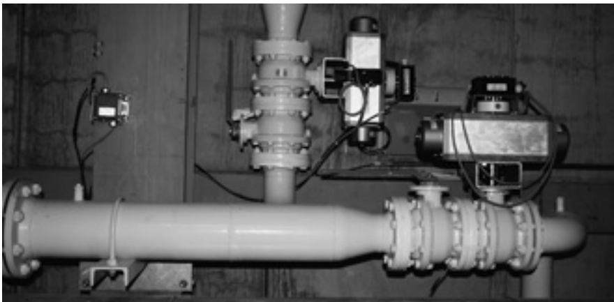
«Weiche» Halterungen der Gas-Zuleitung beim Mengen-Umwerter im Keller.
