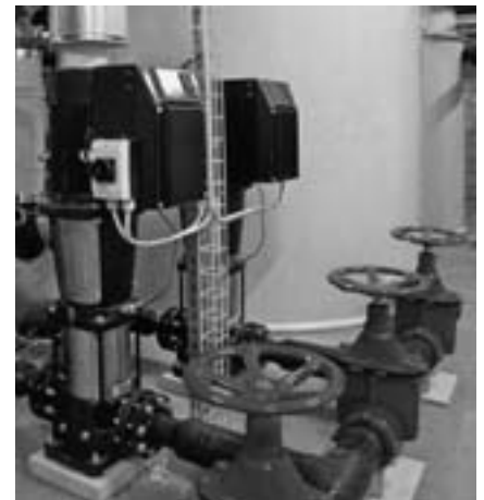
Pumpstation/Wasserhaus für Tiefenwasser aus 200m Fördertiefe.
