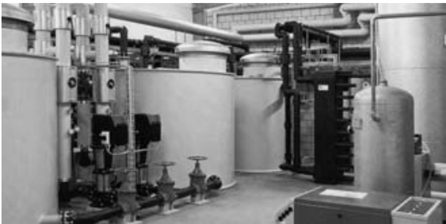
Behälter zur Speicherung des warmen Tiefen-Thermalwassers mit Wärmetauscher.
