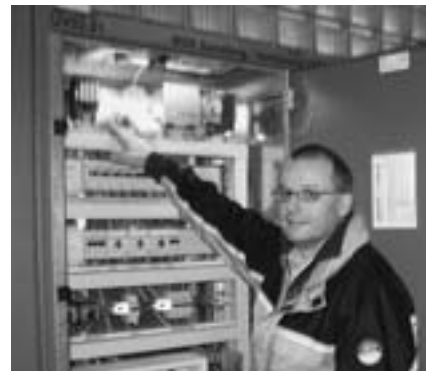
Marcel Schöb, Projektleiter der IBG Graf AG, St. Gallen, am Schaltschrank mit den Rechner-Einheiten.
