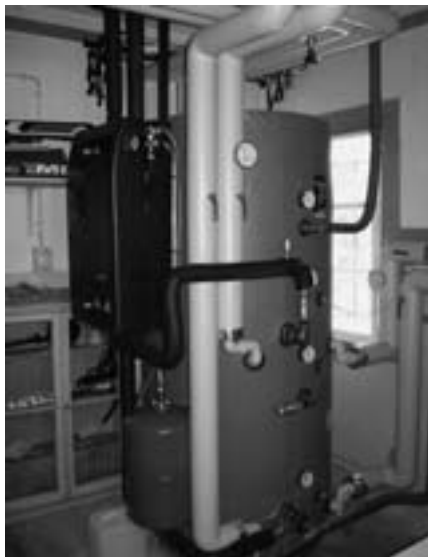
Heizungsanlage mit Warmwasserspeicher und angebauter, kompakter Solarstation samt Regelung «Oventrop».
