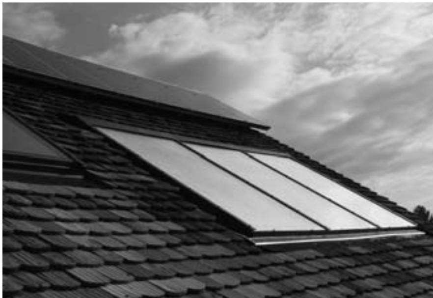
Dachfläche mit Fotovoltaikanlage und (unten rechts) Solarkollektor für Warmwasser.
