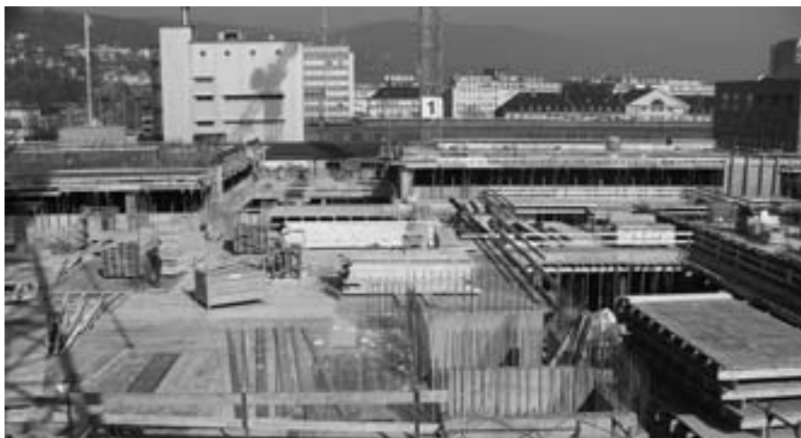
Blick auf eine Baustelle der Thuner Generalunternehmung Frutiger AG. Foto: Frutiger AG
