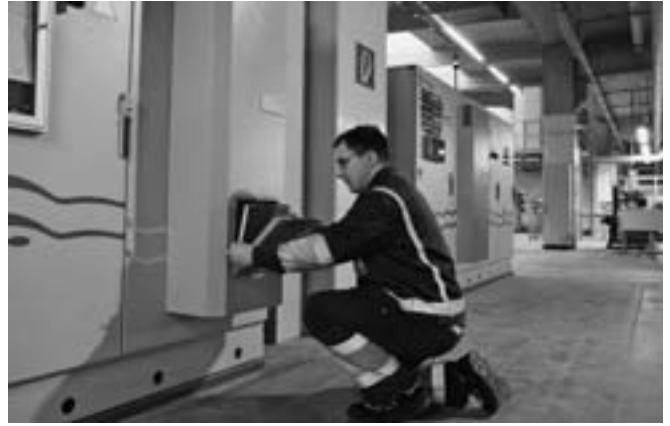
Nach der «kinderleichten» Montage und Wartung eines «Pfannenberg»-Filterlüfters der 4. Generation wusste Daniel Voigt, welcher die Elektronik der Fussboden-Anlagen im «Egger»-Werk Wismar (D) überwacht, dass die «Pfannenberg»-Bezeichnung «Der besonders servicefreundliche Filterlüfter» sowie der Begriff «Klack und sitzt!»-Einbau keine Übertreibungen sind.
