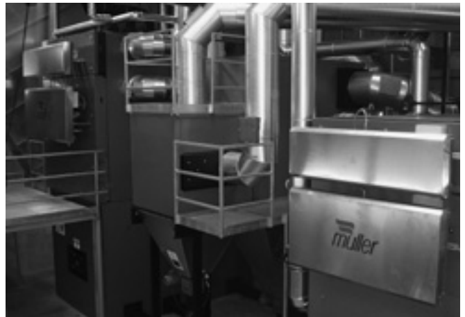
«Müller»-Holzschnitzel-Feuerung (Leistung 4 MW) in Sumiswald BE mit automatischer Kesselzug-Reinigung und automatischer Entschung. Bilder: Müller AG Holzfeuerungen
