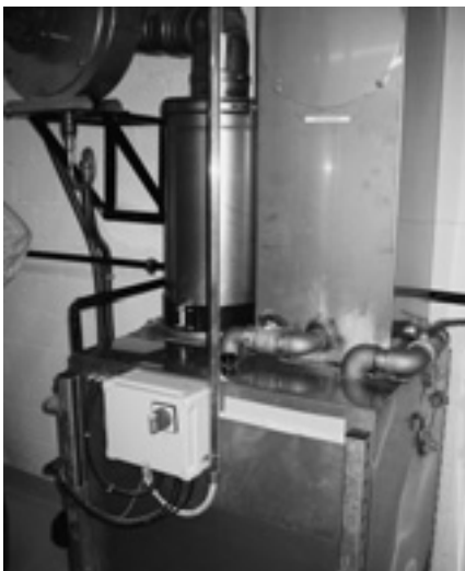
Blick auf den Rauchgaswascher in Tamins GR.
