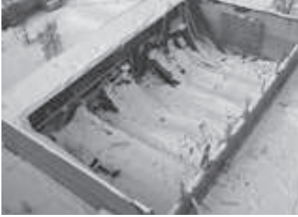
Hallenbad Uster, 10. Mai 1985: Schadensbild am Morgen nach dem Deckeneinsturz. Die Empa-Experten suchen nach Spuren für die Ursache des Unglücks.
