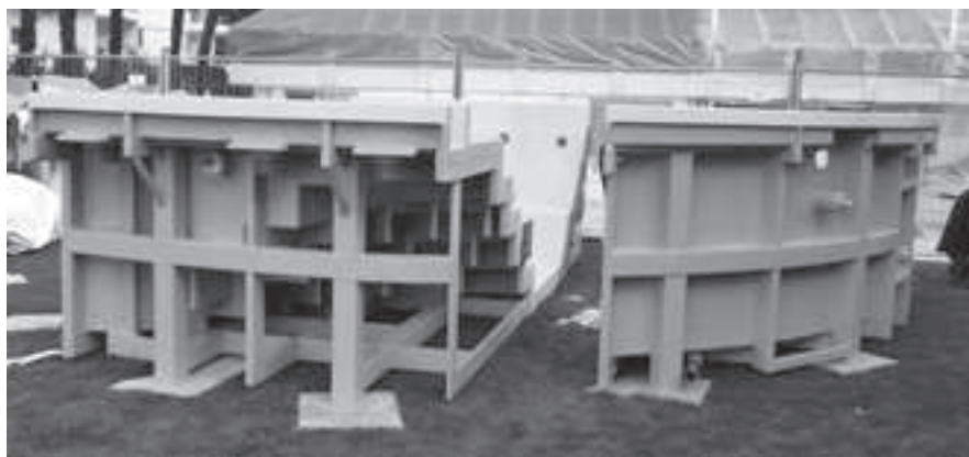
Der Hydropool wurde in zwei grossen, transportfähigen und den Einbringmöglichkeiten angepassten Beckenteilen angeliefert.
