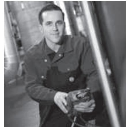
Monteur Can Bozarslan beim Messen und Aufzeichnen des Differenzdruckes im Kältemittelkreis einer Kältemaschine.
