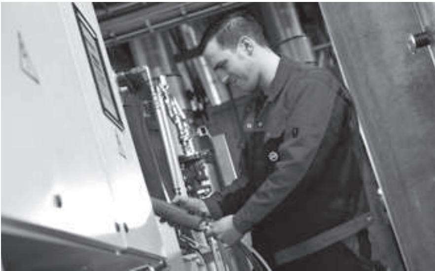
Viele Kälteanlagen müssen in den kommenden Jahren den neuen Vorschriften angepasst werden. Eine rechtzeitige Überprüfung ist von Vorteil. Bilder: ISS Schweiz AG
