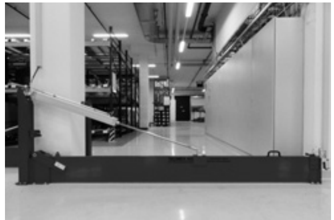
Störfallsystem Talimex: vollautomatische Barriere Talimex BED/PM als Auslaufsperrre zur Rückhaltung von Löschwasser.
