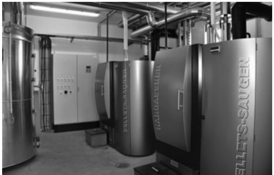
Mit der ausgeklügelten Kaskadenregelung von Hargassner werden die einzelnen Pellets-Heizkessel von Hargassner der Reihe nach zu- und weggeschaltet.
