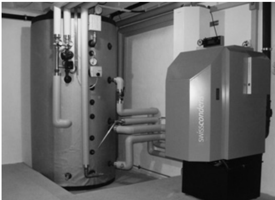
Ölbrennwertkessel (rechts) mit Boiler (links).
