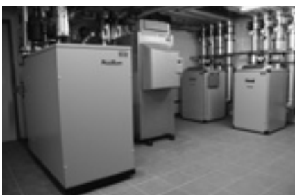
Von links nach rechts im Bild das Gasmotor-Blockheizkraftwerk, der Gas-Kondensationskessel und die beiden Erdsonden-Wärmepumpen.
