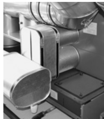
Die beiden Rücklaufstutzen am UltraGas-Brennwertkessel.
