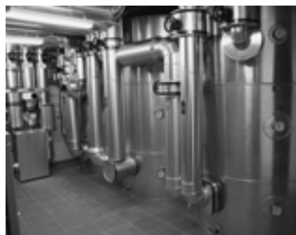
Die Speicher für Warmwasser für das Wasserprüflabor, Wärmepumpen und BHKW.
