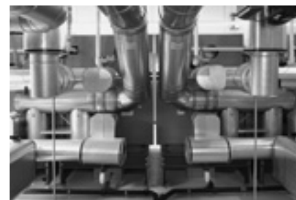
Doppelkesselanlage: Jeweils zwei Heizkessel arbeiten auf eine Abgasleitung und einen Kamin.
