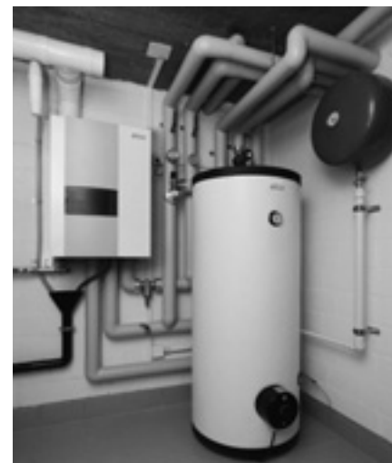
Blick in den Heizungskeller mit dem neuen Gas-Brennwertkessel Thision von ELCO und beige gestelltem Wassererwärmer.
