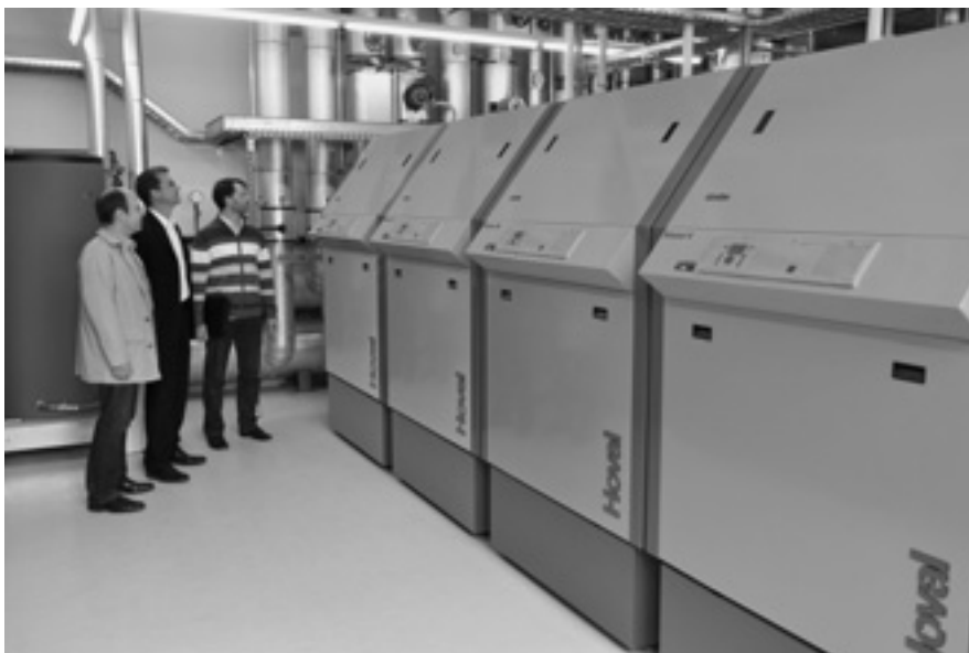
Kaskade mit vier UltraGas-Brennwertkesseln à 720 kW, Heizleistung total 2620 kW, Umlaufwassermenge: 225 m 3 /h, Spreizung: 80 / 70 °C.
