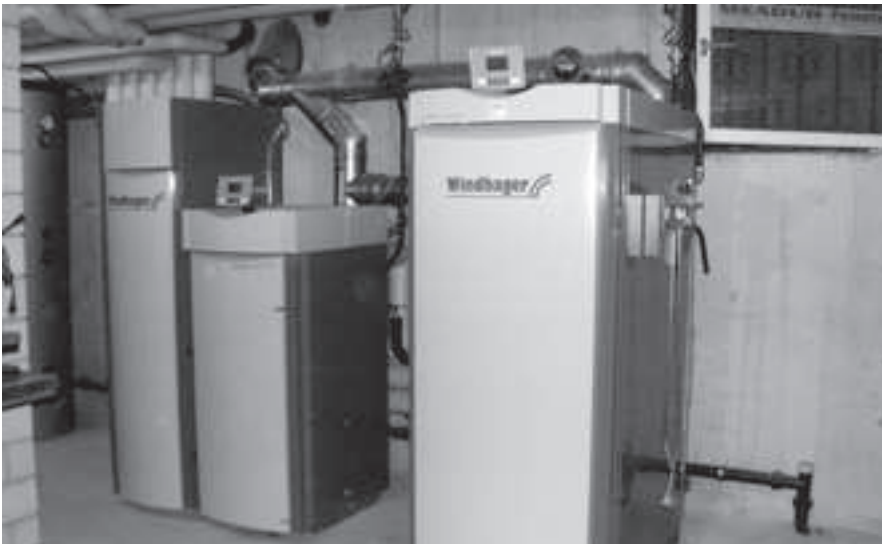
Blick auf die neue, von der Windhager Zentralheizung Schweiz AG gelieferte Pellets-Heizung.
