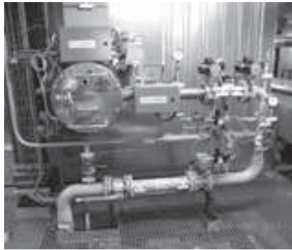
Feuerraum mit Anfahr- und Stützfeuerung und Erdgas-Zuleitung.
