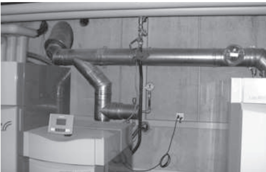
Der Heizkessel BioWIN wird als automatische Feuerung zur Unterstützung für den Holz-Heizkessel LogWIN eingesetzt.
