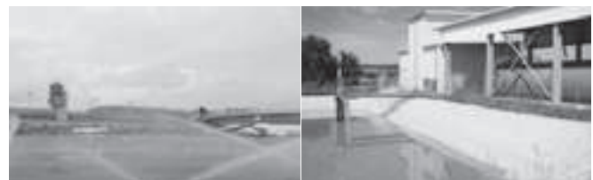
Verregnungsfläche sowie Stapelbecken für stark belastetes Enteiserabwasser, Gebäude der Destillationseinheit, Tank für gewonnenes Konzentrat.
