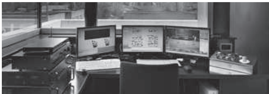
Blick in den Kommandoraum im 1. OG.
