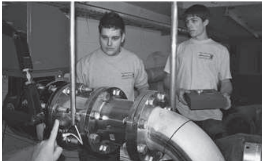
Die aus dem Jahr 1970 stammenden Pumpen im Reservoir Obstgarten in Frauenfeld TG sind in die Jahre gekommen und wurden ersetzt.
