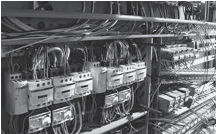
Die alte Elektro-Hauptverteilung (Bild) zur Steuerung der Wasseraufbereitung, der Wasserreinigung vor der Rückführung in den See sowie der Wärmepumpe für alle drei Schwimmbecken wurde ersetzt.
