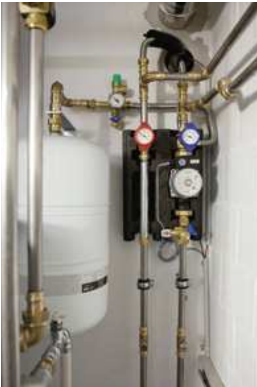
Solar-Vor- und -Rücklauf mit Temperaturanzeige und Pumpe.
