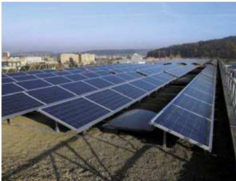
Blick auf die 640 m 2 grosse Photovoltaikanlage auf dem Dach der CWK-SCS in Winterthur ZH.
