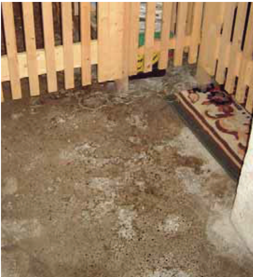
Muffiger Keller durch Bodenfeuchte.
