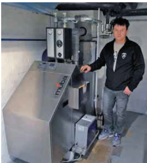
Liegenschafts-Besitzer Ralph Heitz neben dem neuen Ölbrennwertkessel von Muba.
